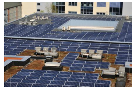
Bildquelle: Mp-tec GmbH & Co. KG, Anlage in der Reuchlinstrasse, die Mp-tec als Generalunternehmer fertigte
